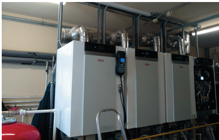
■ Котельная медицинского центра «Сакура», Челябинск
