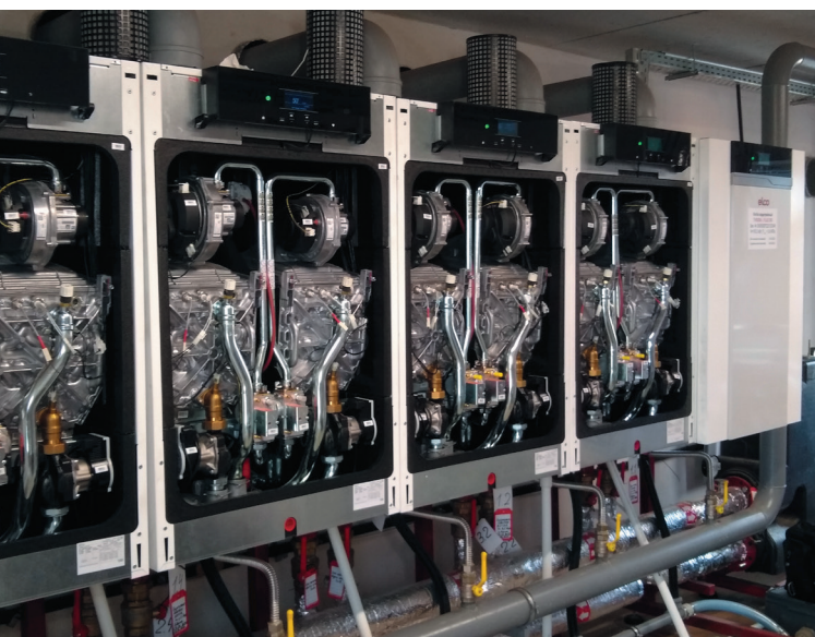
■ Котельная ЖК «Горький», Калининград
