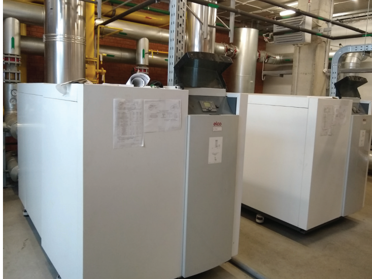
■ Котлы ELCO в крышной котельной
