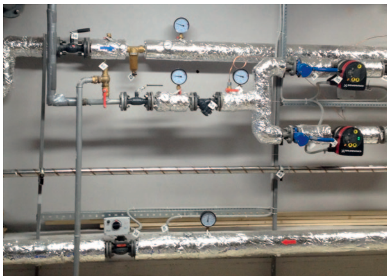
Рис. 2. «Планшетный ИТП» в подвале современного административного здания
