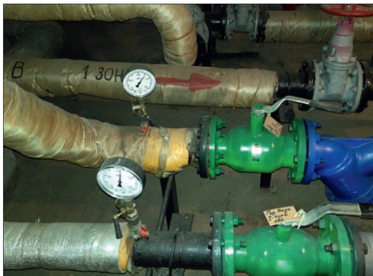
Рис.1. Магистральные трубопроводы в изоляции
