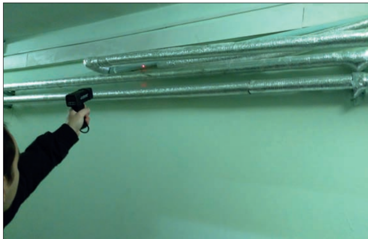
Рис.3. Определение температуры труб ГВС
