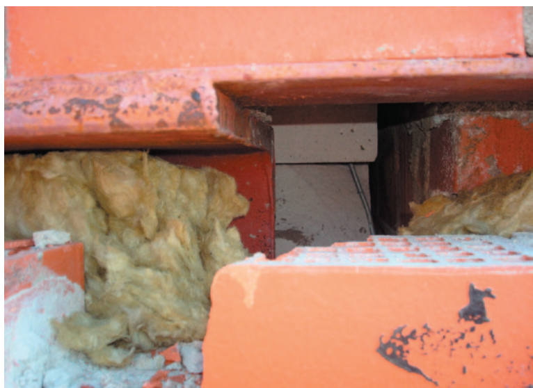
Рис. 3. Выбоина в месте установки гибкой связи в слое кладки из газобетонных блоков двухслойной стеновой конструкции
