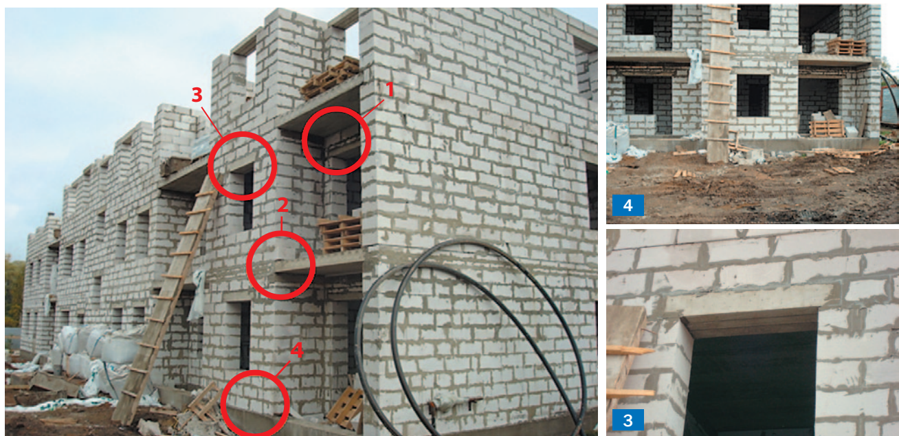
Рис. 1. Теплопроводные включения в оболочке строящегося жилого дома:
